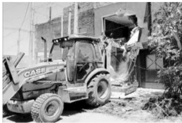
El momento en que se tira abajo un inmueble señalado como búnker.
