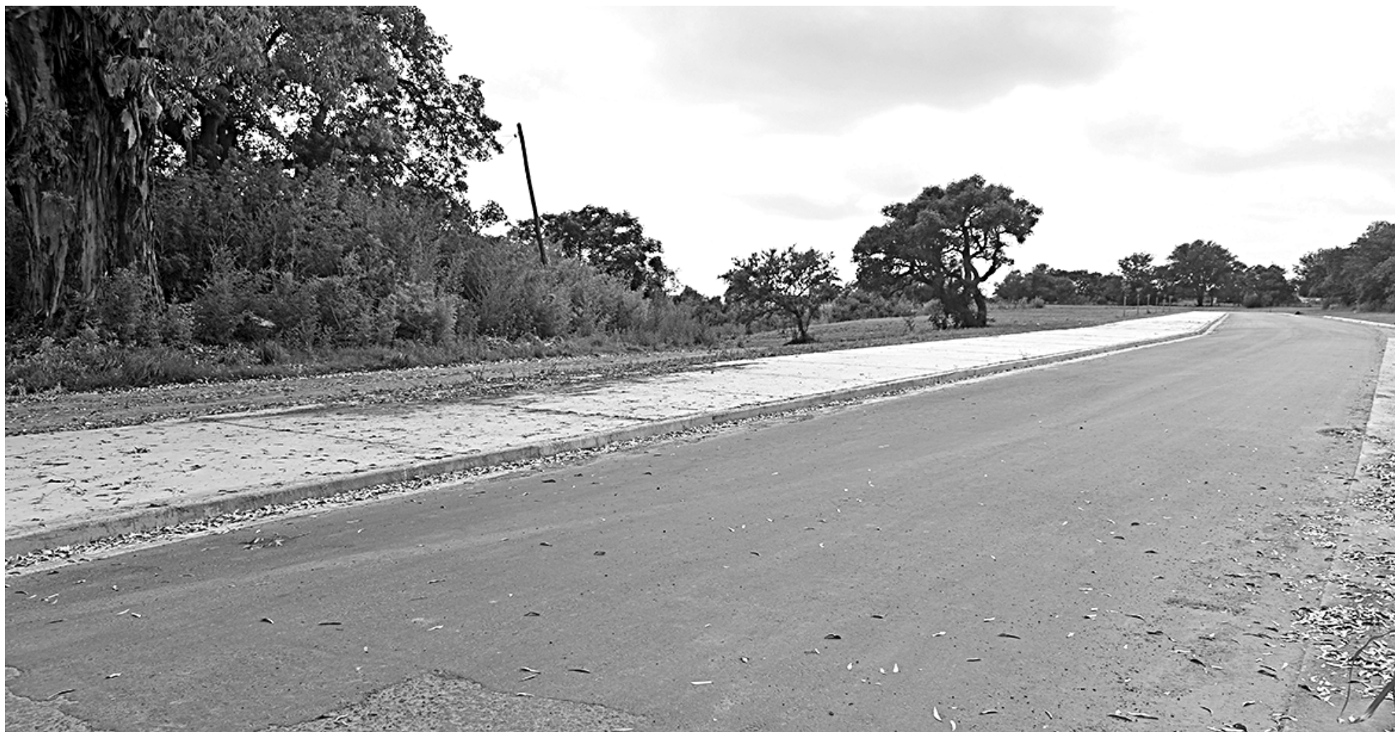
Esta es la intersección de Volta y Marconi, hasta donde llega actualmente el avance de la obra. IARA CERASI/EL NORTE
