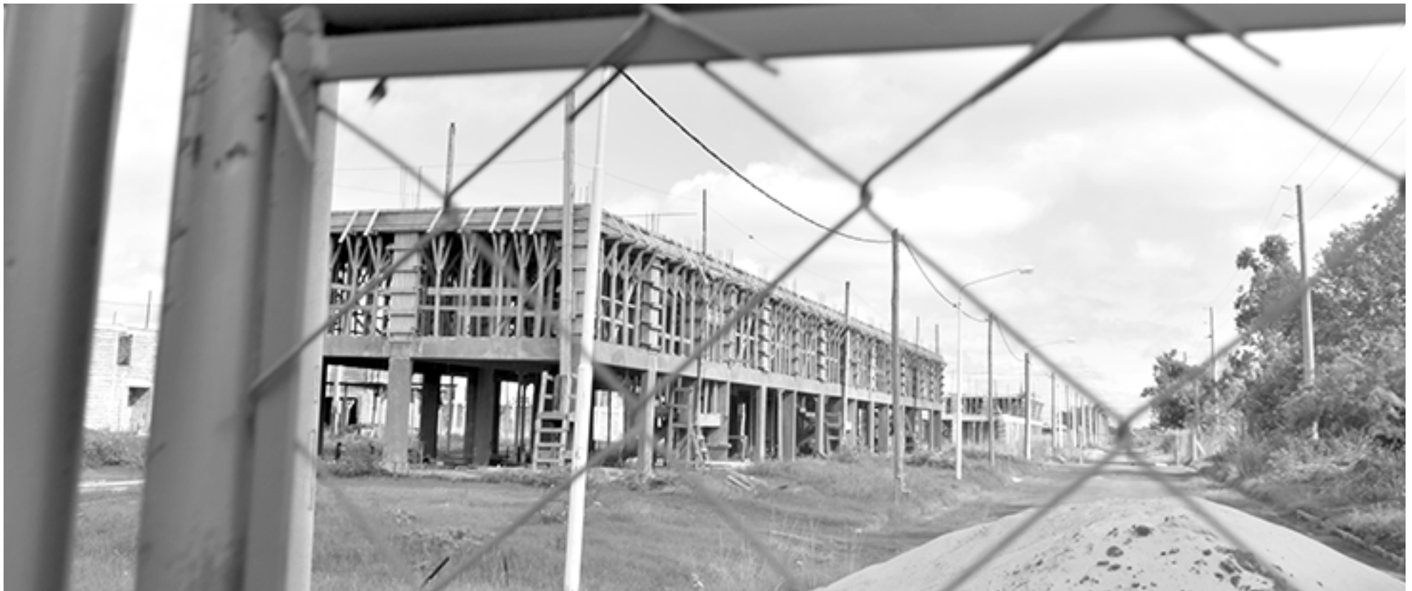
De acuerdo con los planes originales, la obra iniciada en mayo pasado tiene un plazo de ejecución de 12 meses: hoy está con un grado de avance de apenas el 30%. IARA CERASI / EL NORTE
