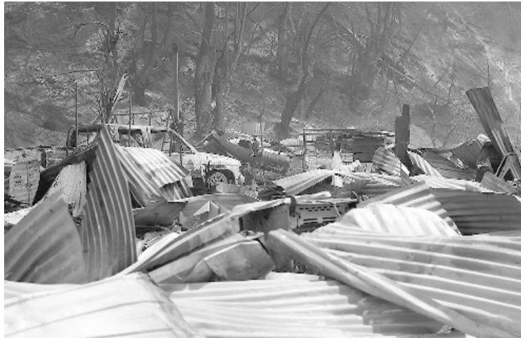
Destrucción. El paso del fuego por Viña del Mar. - Xinhua -
